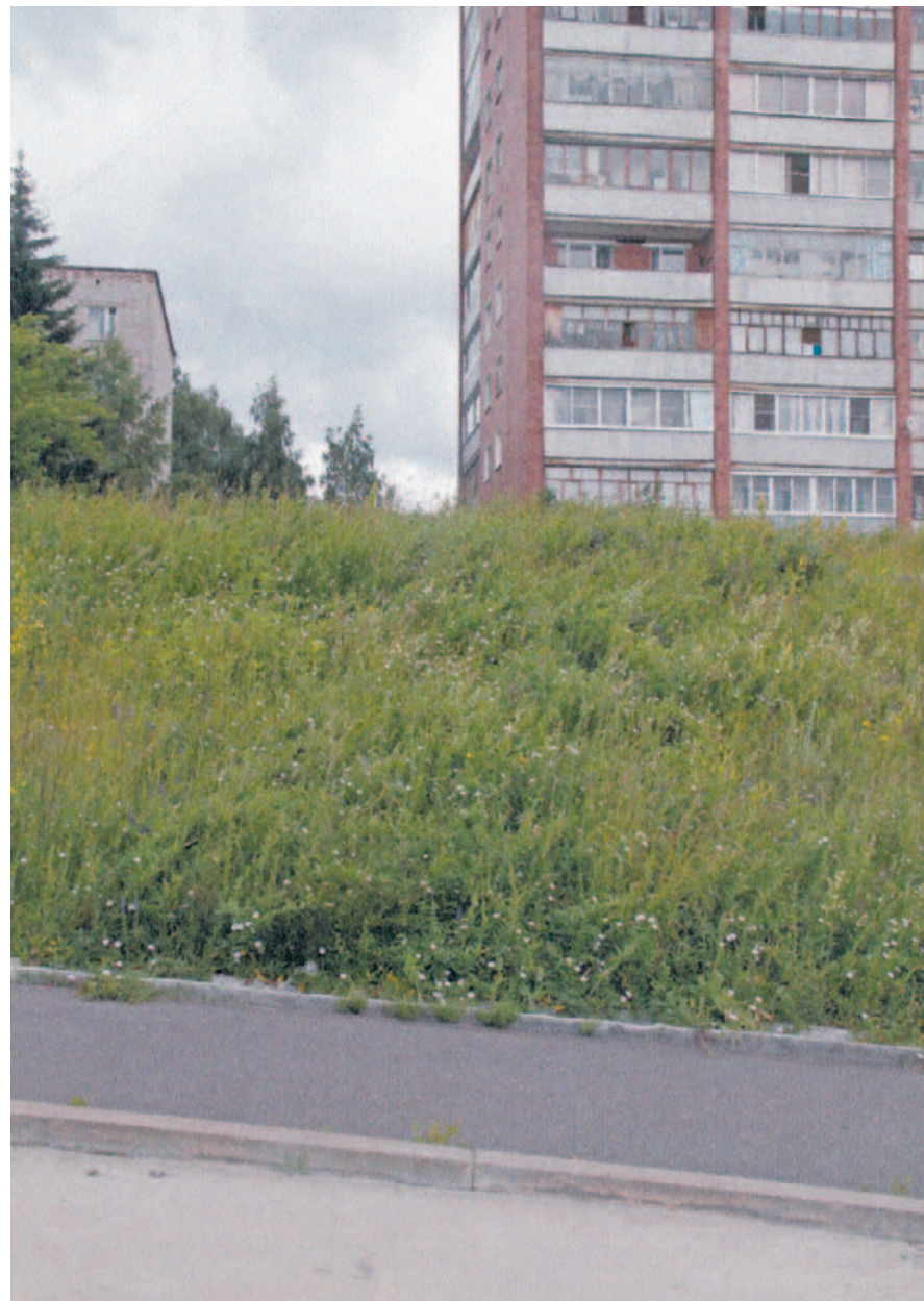
Рис. 54. Состояние откоса у многоэтажки до берегозащиты — стало
