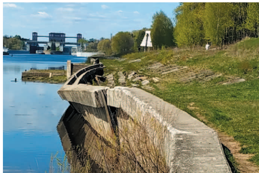
Рис. 44. Состояние защитной стенки — стало
