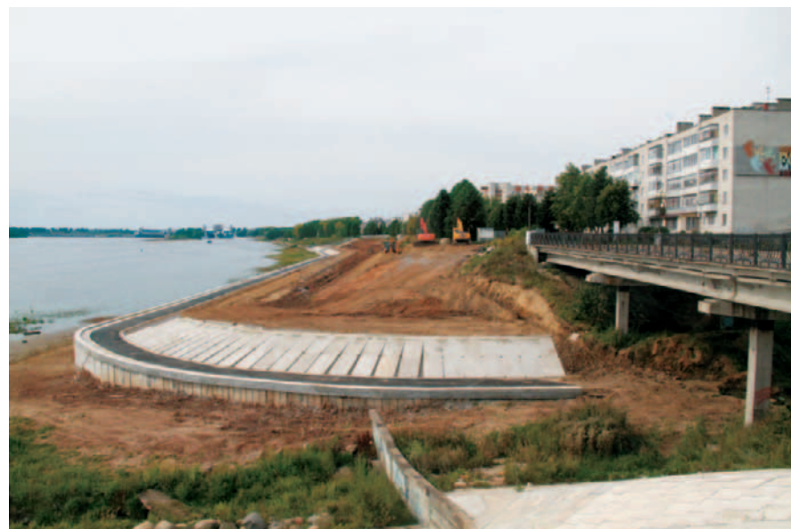
Рис. 28. Примыкание к мосту через ручей — стало
