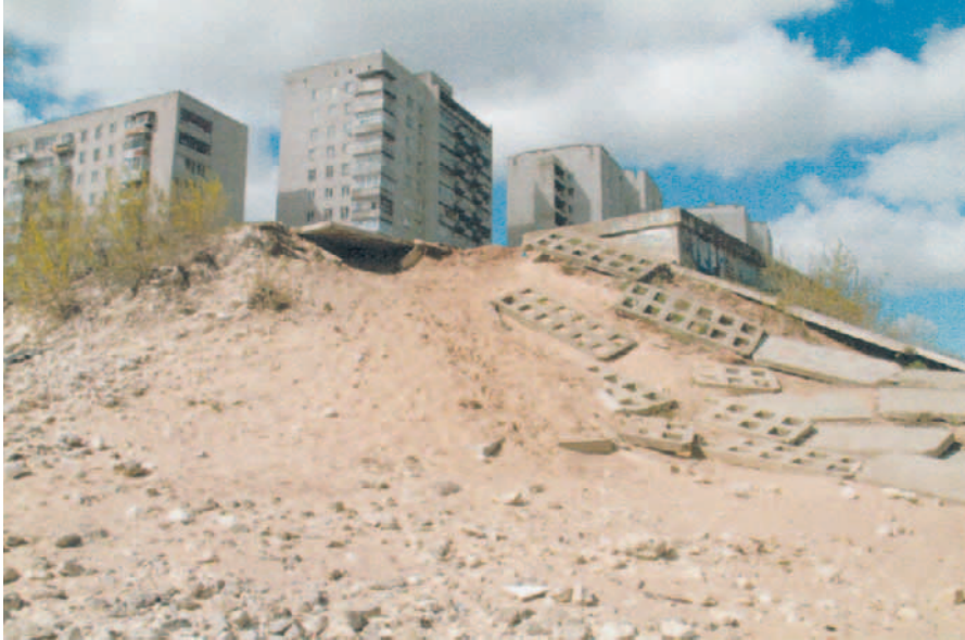
Рис. 55. Разрушение незавершенного берегоукрепления
